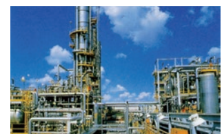
圧力用配管(プラント)
